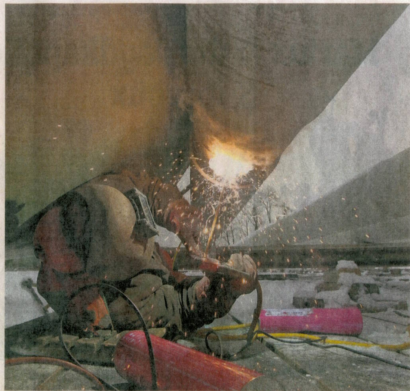
Beim Zusammenschweissen der Stahlrohre am Seeufer im Pfäffiker Unterdorf ist Präzision gefragt. Foto: PD
